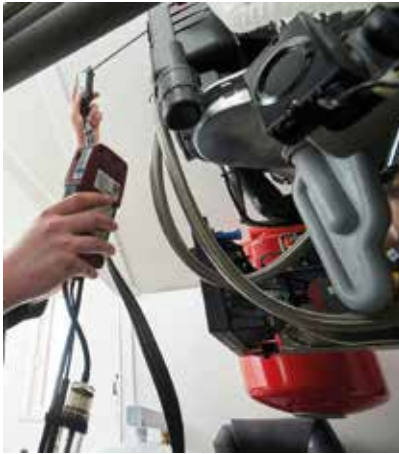
Onderhoud cv ketel
